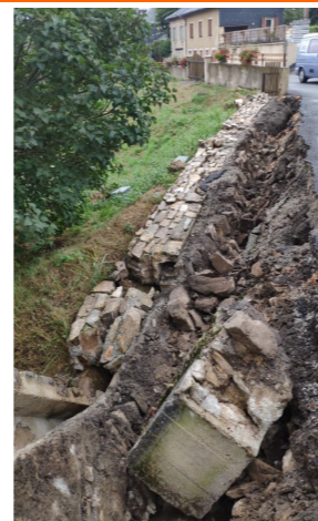
Photo prise juste après la chute du mur à Nages
