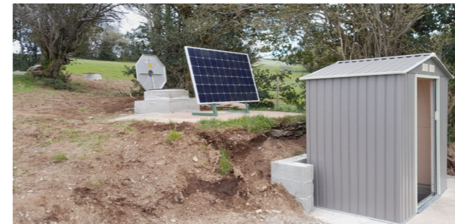
Les installations techniques du captage de Montredon
