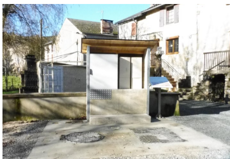
Poste de relevage et armoire électrique de la rue de la Foun dal Loc
