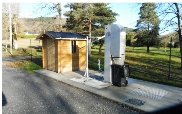
Local de commande et dégrilleur automatique des déchets à la station du Landas
